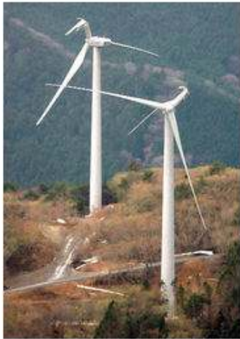
強風で羽根が大破した風力発電施設＝8日午後、静岡県東伊豆町、本社ヘリから、堀英治撮影
